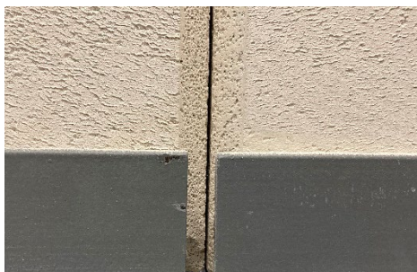
写真4 シーリング無しの隙間
